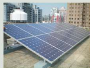
太陽光電發電系統
